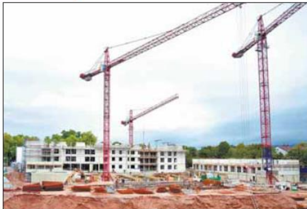
Heidelberg fehlt Wohnraum. Und Neubauprojekte wie der Kranichgarten im Pfaffengrund – hier ein Foto vom Bau im Jahr 2010 – sind nur ein Tropfen auf den heißen Stein. Foto: Alex
